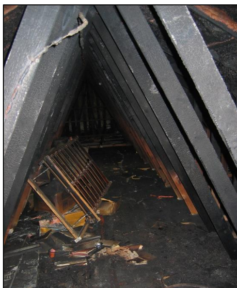
Figura 2 Vista da escada para o sótão. A foto mostra como o espaço do sótão é estreito. (Foto: Corpo de bombeiros Westhoek - estação Diksmuide)
