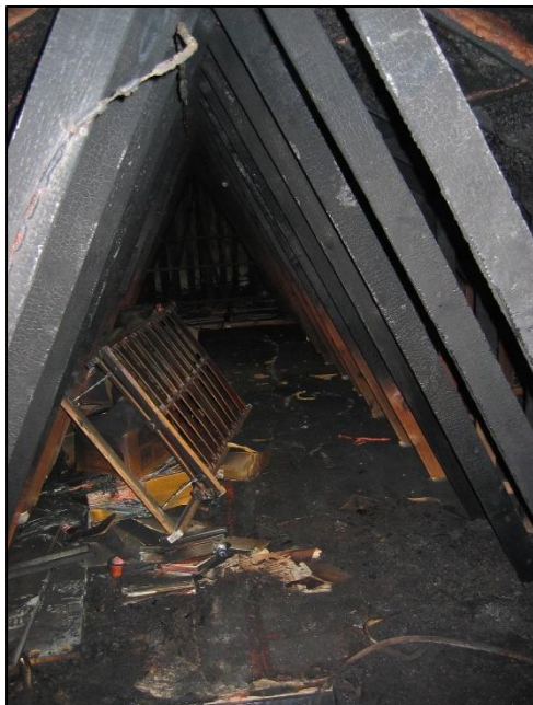
Figura2 Vista desde la escalera hacia el ático. La foto muestra cuán estrecho es el espacio del ático. (Photo: Fire service Westhoek – station Diksmuide)
