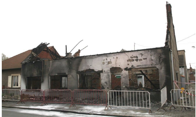
Bild 3 Nach einem Brand stehen nur noch die Grundmauern. Mit Absperrgitter und Signalband wird der Trümmerschatten gesichert. (Foto: Herman De Wit)
