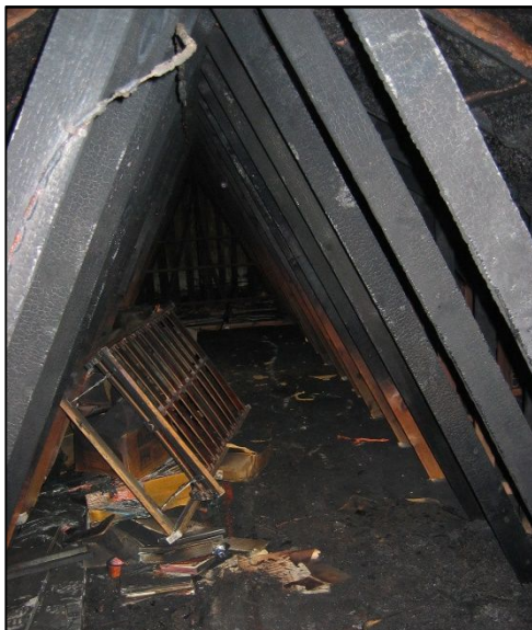
Bild 2 Blick aus der Treppenöffnung in die eine Seite des Speichers. Das Bild zeigt sehr gut, die räumliche Beengung des Speichers. (Foto: Feuerwehr Westhoek – Posten Diksmuide)
