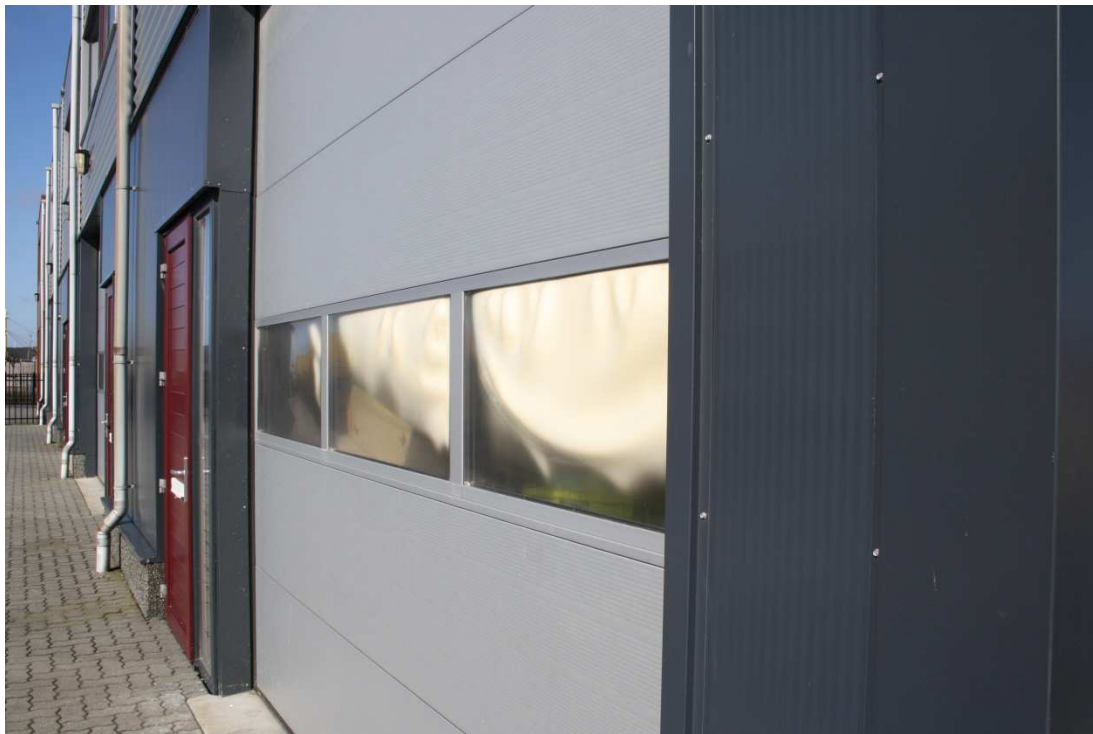
Afbeelding 22 Uitgezakte beglazing (polycarbonaat) in overheaddeur
