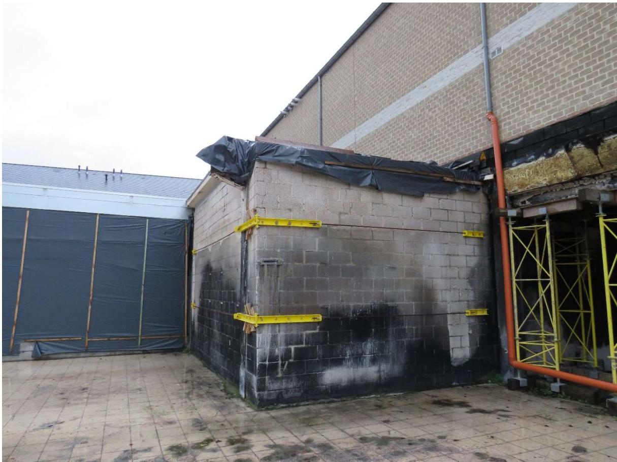
Vue du mur des « caves » des appartements. Ce volume est inclus dans le volume en feu et a fortement souffert de son exposition à la chaleur
