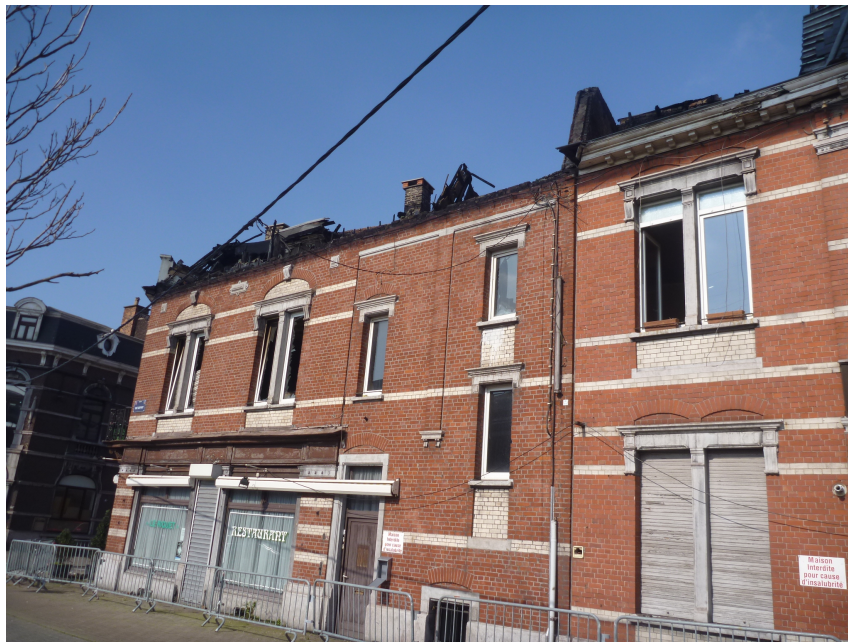
Vue de la façade delta et des toitures endommagées
