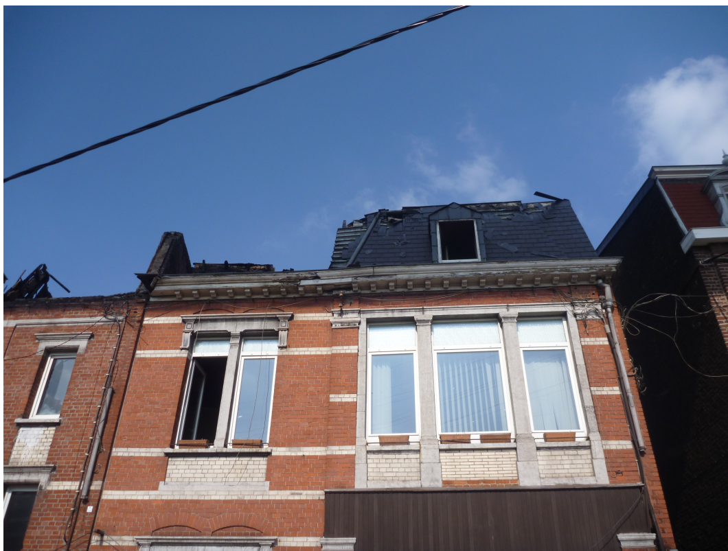
Vue des toitures depuis la rue Goffart. A droite, le passage en façade delta
