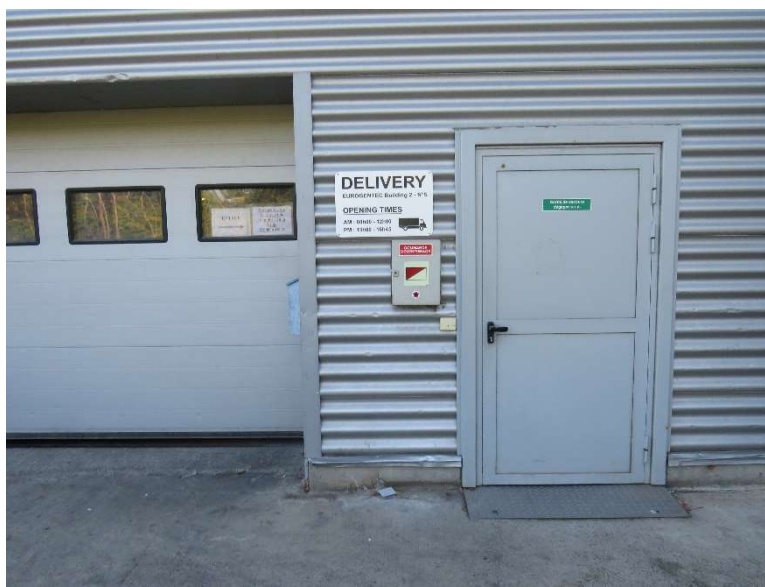
Commande de l'installation de désenfumage située au rez de chaussée en façade delta
