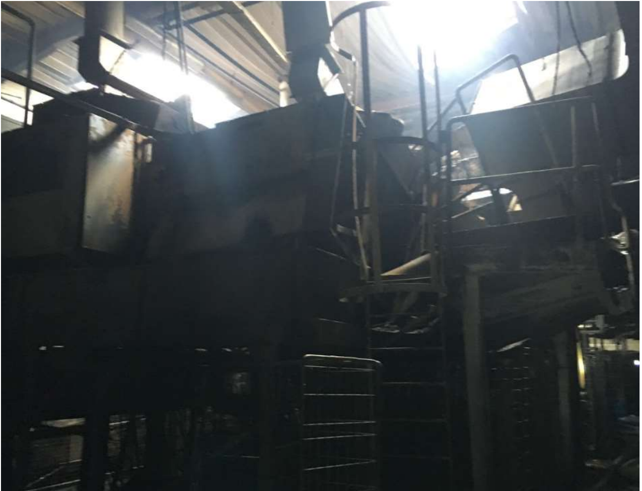
Figuur 19 Ingezakte afzuiginstallatie droger en droger
